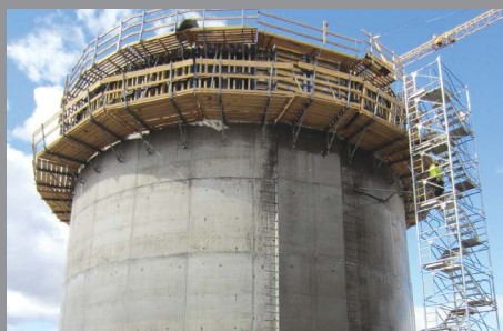
Planta de Biogas Tartu, Estonia
