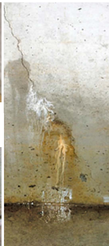
Filtraciones a través de grietas y juntas
