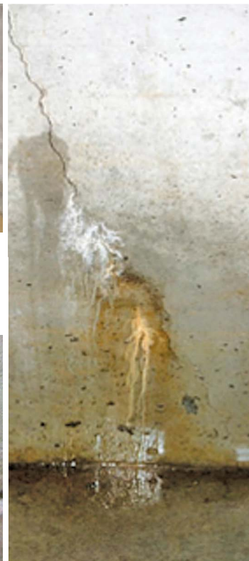
Filtraciones a través de grietas y juntas
