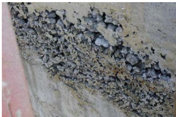
Ejemplos de áreas de mala consolidación del concreto
