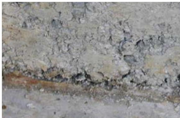
Ejemplo de mala consolidación de la junta de muro a losa
