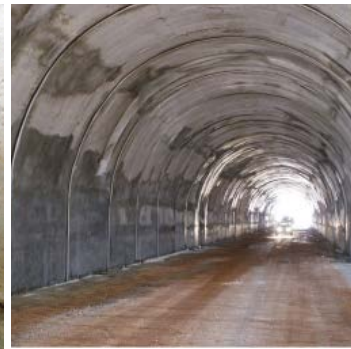
Filtración al interior de túneles
