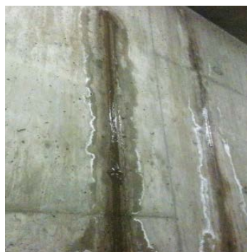
Filtración en juntas
