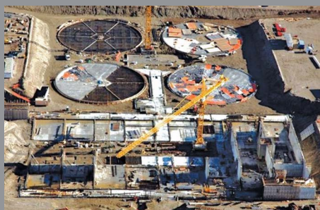
Canadá, PTAR Pine Creek
